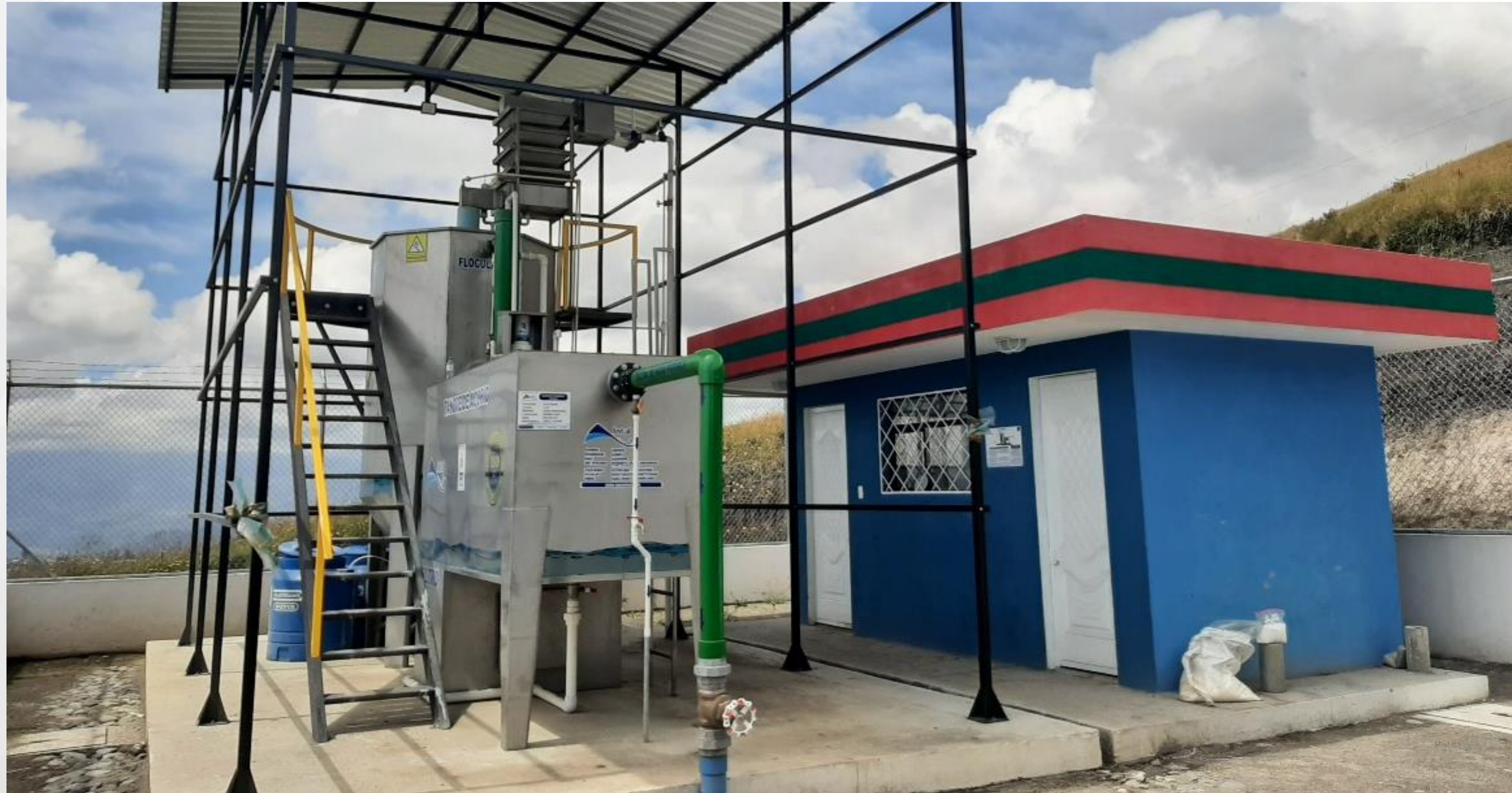
Planta de Agua potable comunidad Cullitahua Constantino Fernández
